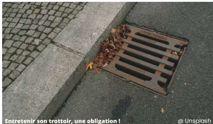
Entretenir son trottoir, une obligation !
